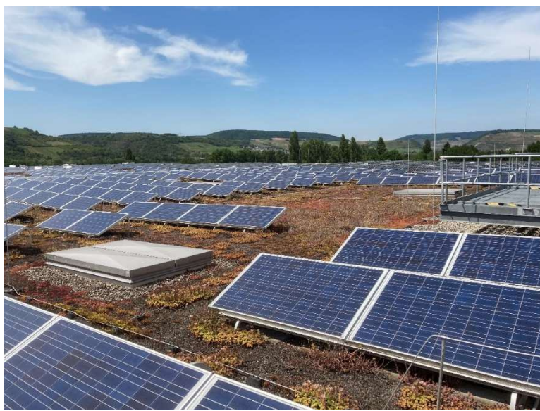
Abbildung 44: Beispielhafte Darstellung einer extensiven Dachbegrünung in Kombination mit PV-Anlagen (Fotoaufnahme: ÖKOPLANA)
