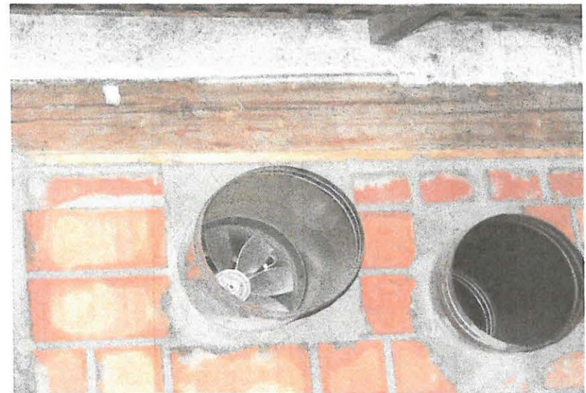
Abluftventilator des Ofen an Außenwand
