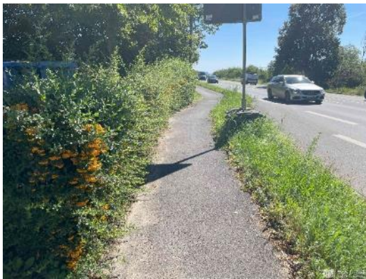
Abbildung 45: Unzureichender Unterhalt/ unzureichende Pflege der Verkehrsanlage (L 3005 | Frankfurter Straße)
