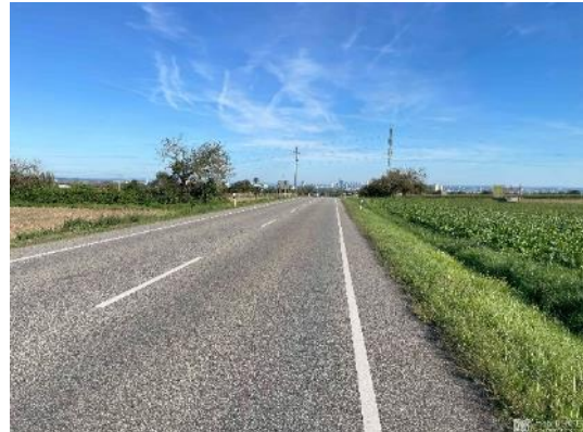
Abbildung 104: Fehlende Fuß- & Radverkehrsanlage entlang der K 768
